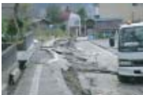
大規模な道路亀裂が発生(04.11.2)
