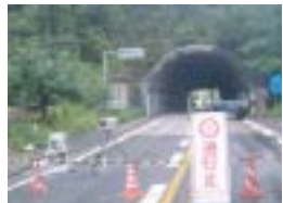
国道17号川口町和南津トンネル損壊(04.10.26)
