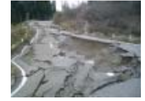
長大な亀裂と陥没(04.11.18)
