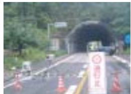
国道17号川口町和南津トンネル損壊(04.10.26)
