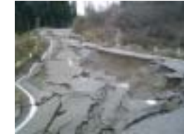
長大な亀裂と陥没(04.11.18)
