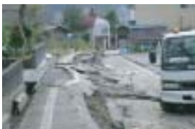
大規模な道路亀裂が発生(04.11.2)
