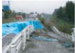
川口町天納地先 JR上越線脇の国道17号で道路崩壊(04.10.26)
