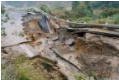
大規模な道路損壊
