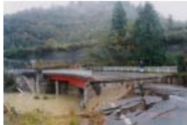
梶金橋の損壊
